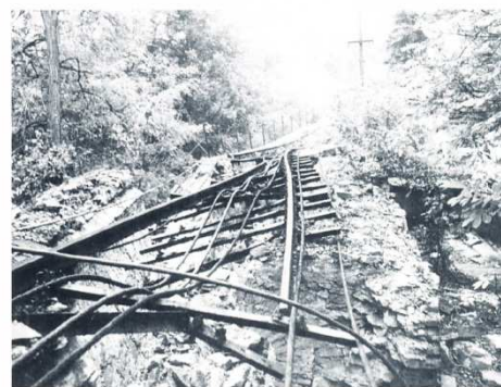
Rozsáblé sesuvy půdy na Petříně v letech 1965 a 1967 zničily těleso lanovky.
